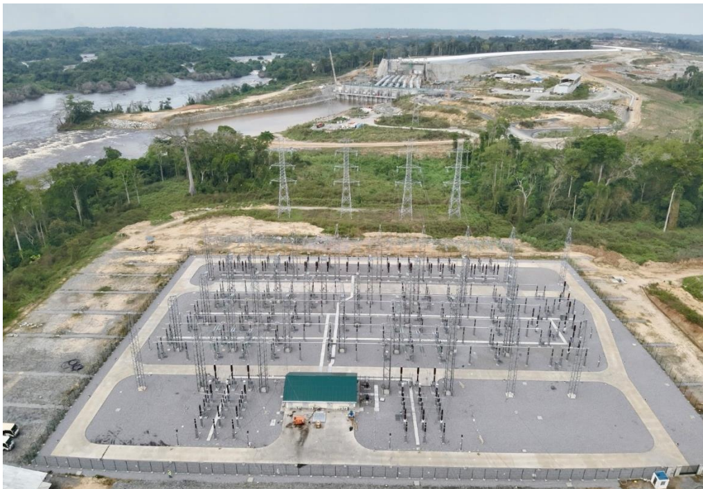
Vue aérienne du poste de transformation de Nachtigal
