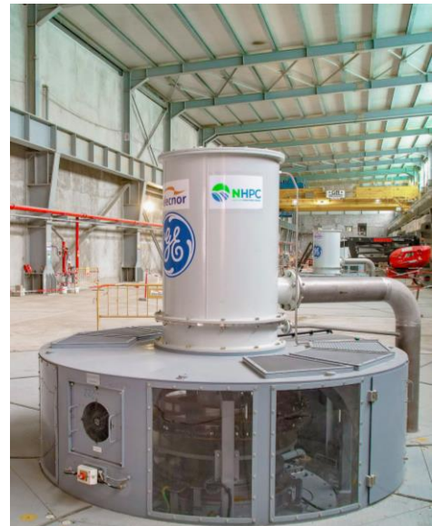
Photo du groupe N°4 de l'aménagement hydroélectrique de Nachtigal
